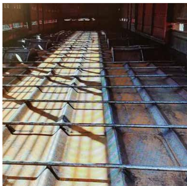
Figura 6. Pisos inadecuados según la Resolución SENASA 503/2022. Este piso si bien aparenta ser una malla cuadriculada, no es acorde ya que las nervaduras longitudinales son canales que pueden hacer más difícil el agarre, además de que la altura de la nervadura transversal es muy elevada y puede hacer que un animal chico se enganche y tropiece.
