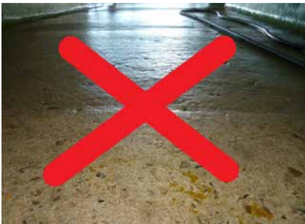
Figura 6. Piso no apto, liso, propenso a generar resbalones y caídas.
