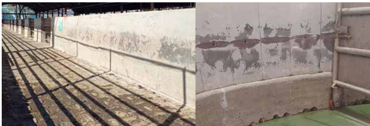
Figura 2. Paredes de corrales ciegas, lisas y sin proyecciones que lesionen a los animales. Pasillo con una pared semi abierta que permite que se proyecten sombras sobre el piso.
